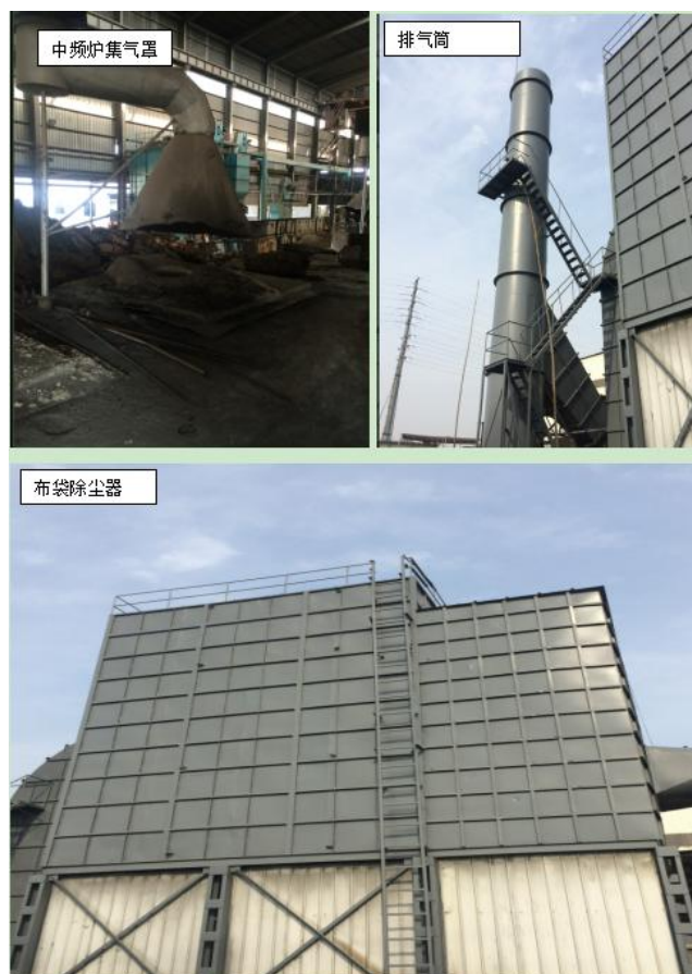
图 4.1-1 该项目熔炼过程的处理设施（集气罩、布袋除尘器）及废气排气筒
