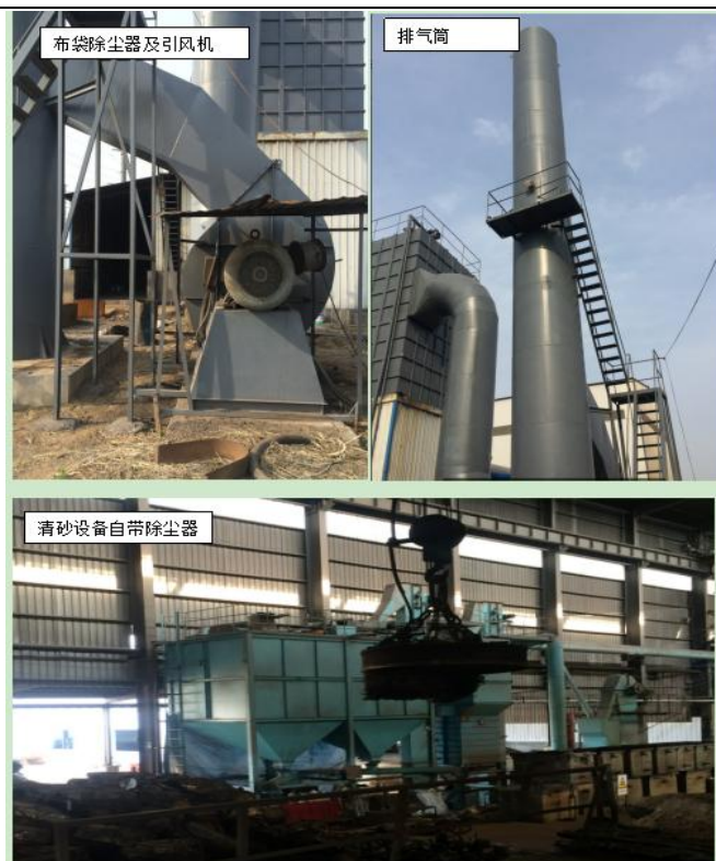
图 4.1-2 该项目清砂工序设备自带除尘器、布袋除尘器及排气筒
