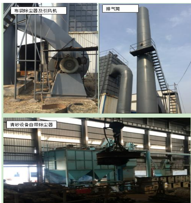
图 4.1-2 该项目清砂工序设备自带除尘器、布袋除尘器及排气筒
