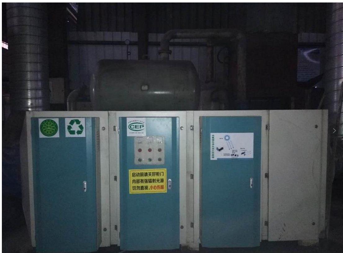
图 4.1-3 该项目浇铸工序光氧氧化设备
